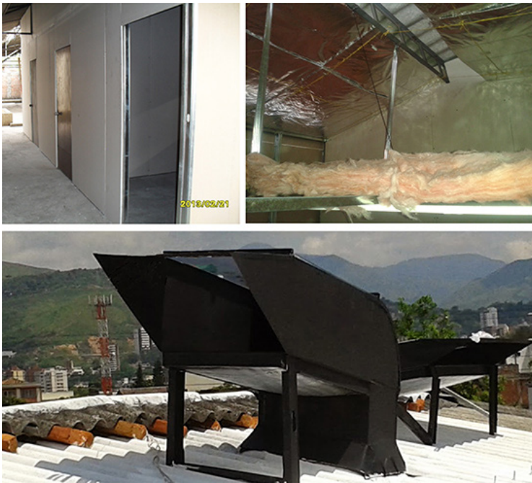
Figura 2. Fotografía del espacio externo (parte superior izquierda), el interior del cielo (parte superior derecha) y las chimeneas externas (parte inferior).
