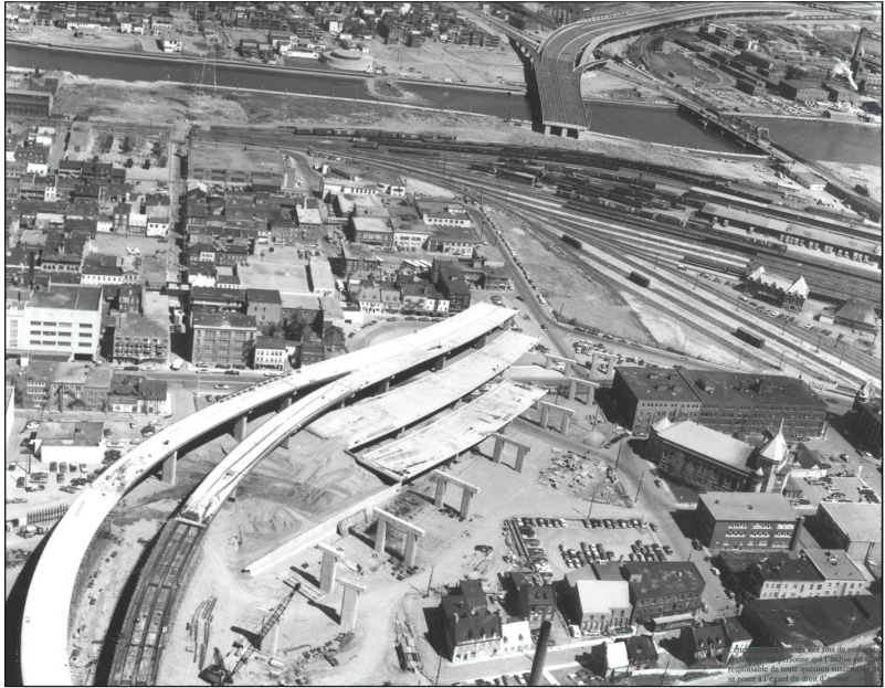
Figura 3. La autopista “Dufferin-Montmorency” en construcción (1974). Archivos de la Ciudad de Québec, Fotografía N° 24646
